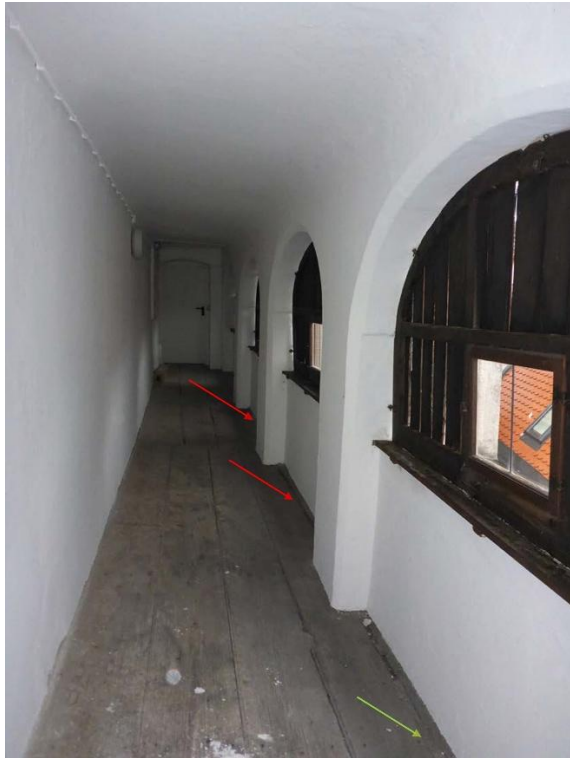
Der Boden senkt sich Richtung „Fenster“
