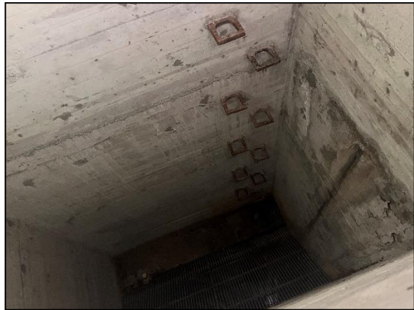
Bild 08: Der Schacht konnte nicht begangen werden, weist aber zumindest einzelne tiefere Spalten auf
