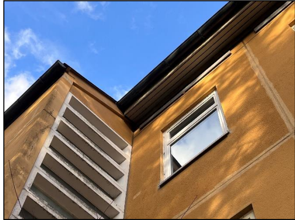
Bild 06: Zumindest in Teilbereichen sind an nahezu allen diesen Gebäuden potenziell geeignete Spaltquartiere hinter Brettern oder in Rollladenkästen vorhanden, auch potenzielle Zugänge zum Dachboden bzw. Zwischendach sind erkennbar
