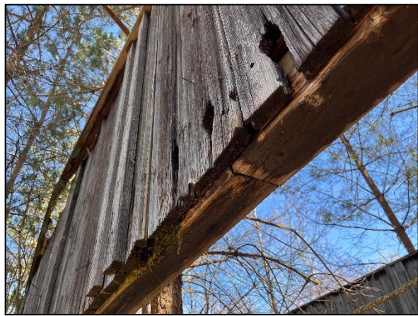
Bild 14: Der ehem. Schießstand im Südosten des UG ist inzwischen zu verrottet, um nennenswertes Quartierpotential aufzuweisen
