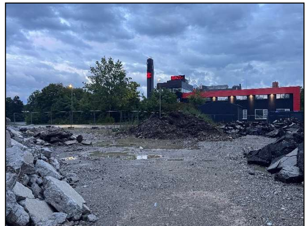
Bild rechts: Kurzfristige Bildung von Pfützen nach Regen im zentralen Bereich
